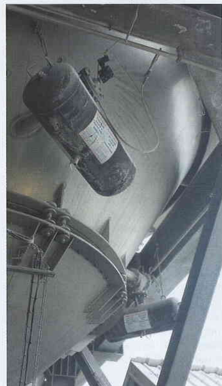
→ Silo avec extracteur vibrant.
