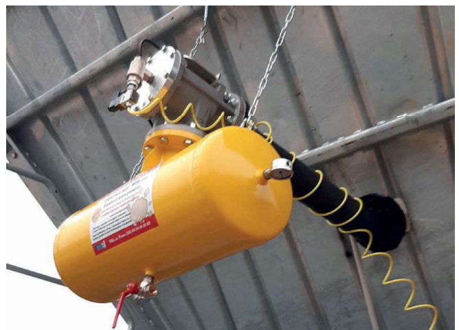
| Installation réalisée chez COLAS sur une trémie de grave mixte.
